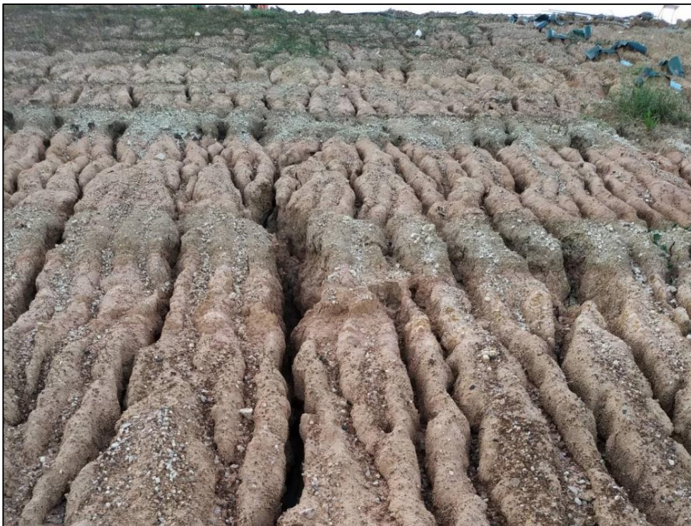
รูปที่ 4-4 ภาพแสดงร่องรอยการกัดเซาะของน้ำฝนบริเวณลาดด้านท้ายเขื่อน
