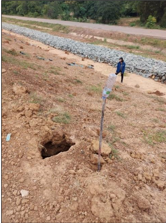
รูปที่ 4-7 หลุมยุบบริเวณลาดเขื่อนด้านท้ายน้ำ
