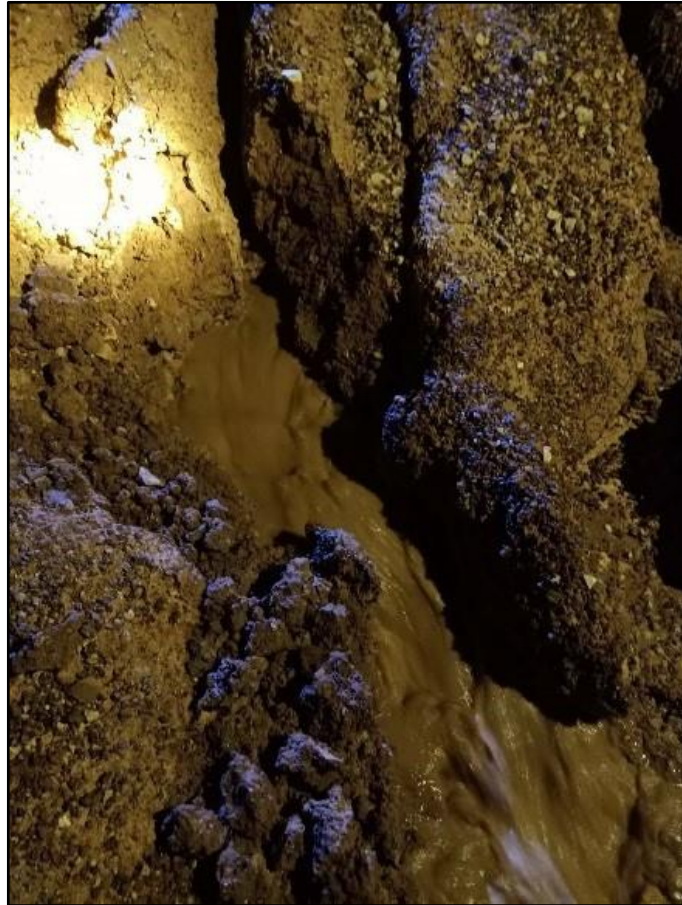
รูปที่ 3-2 สภาพการไหลร่วนของน้ำบริเวณลาดเขื่อนด้านท้ายน้ำ กม.2+158 ระดับ +100.00 เมตร (รสม.) เมื่อวันที่ 21 ตุลาคม 2563 เวลา 21.00 น.
