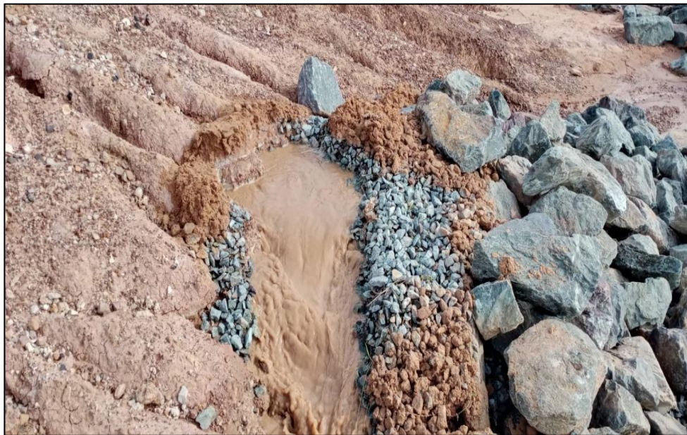
รูปที่ 3-3 สภาพการไหลร่วนของน้ำบริเวณลาดเขื่อนด้านท้ายน้ำ กม.2+158 ระดับ +100.00 เมตร (รสม.) เมื่อวันที่ 22 ตุลาคม 2563
