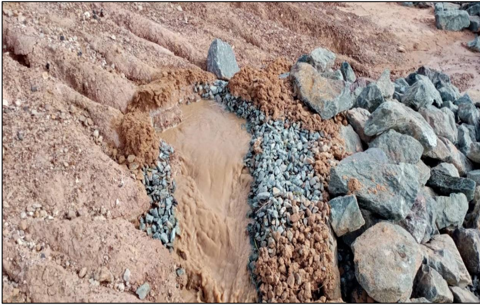
รูปที่ 1-3 สภาพการไหลร่วนของน้ำบริเวณลาดเขื่อนด้านท้ายน้ำ กม.2+158 ระดับ +100.00 เมตร (รสม.) เมื่อวันที่ 22 ตุลาคม 2563
