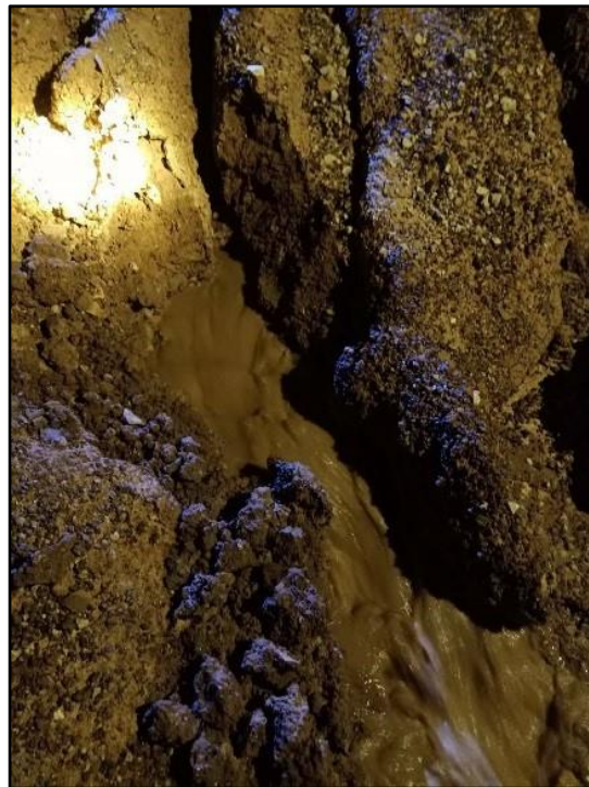
รูปที่ 1-2 สภาพการไหลรั่วของน้ำบริเวณลาดเขื่อนด้านท้ายน้ำ กม.2+158 ระดับ +100.00 เมตร (รสม.) เมื่อวันที่ 21 ตุลาคม 2563 เวลา 21.00 น.
