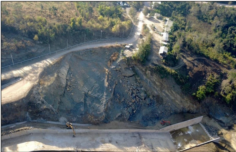
รูปที่ 3-10 บริเวณฐานยันฝั่งซ้ายของอาคารระบายน้ำล้น (Spillway) ที่อยู่ใกล้กับจุดสำรวจ Station 13 มีการขุดเปิดพื้นที่ที่เป็นหินปูนแทรกสลับกับหินทรายแป้ง จึงทำให้เกิดการเลื่อนไถลของมวลหินลงไปตามมุมลาดเอียง การพังทลายของหินเป็นรูประนาบ (Plane failure)
